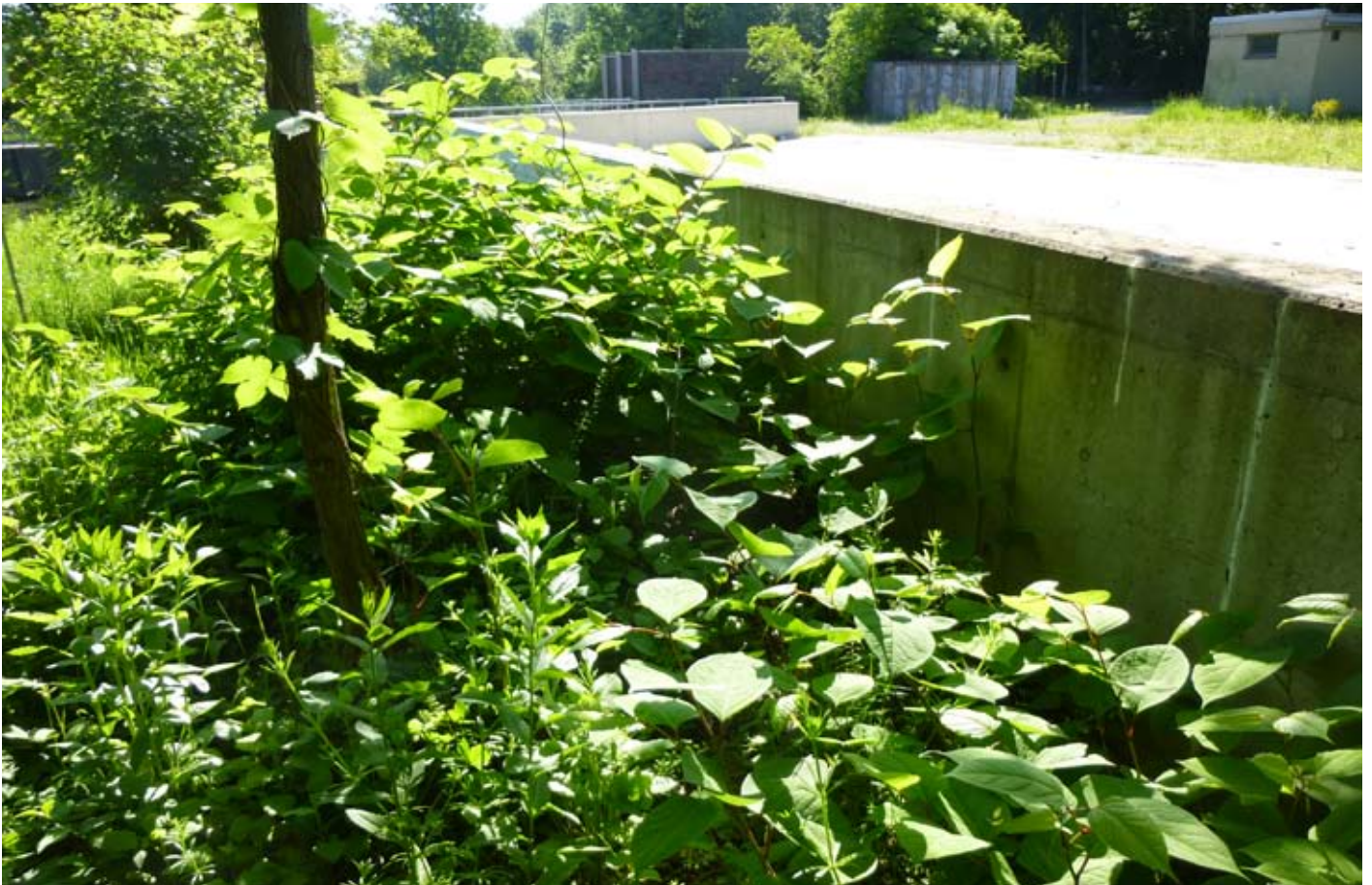
Mauer mit Staudenknöterich (KW Weinzöttl)
