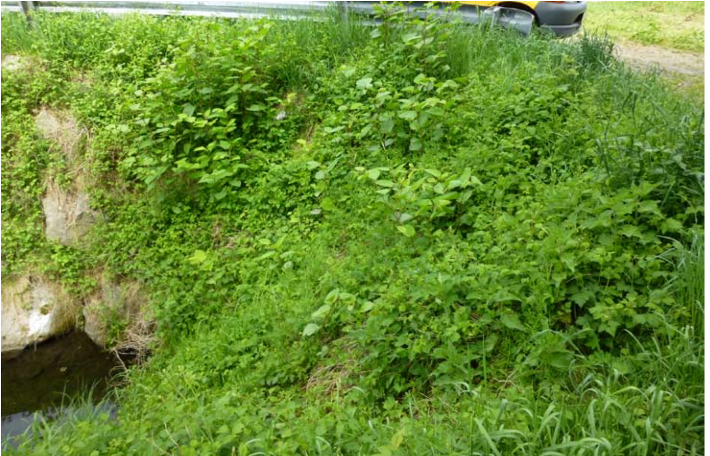
Steilufer mit Staudenknöterich (KW Obervogau)
